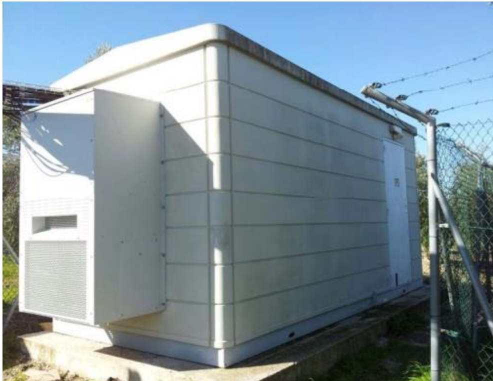
Máquina de AC GEC10-16 instalada en uno de los laterales de cada caseta
