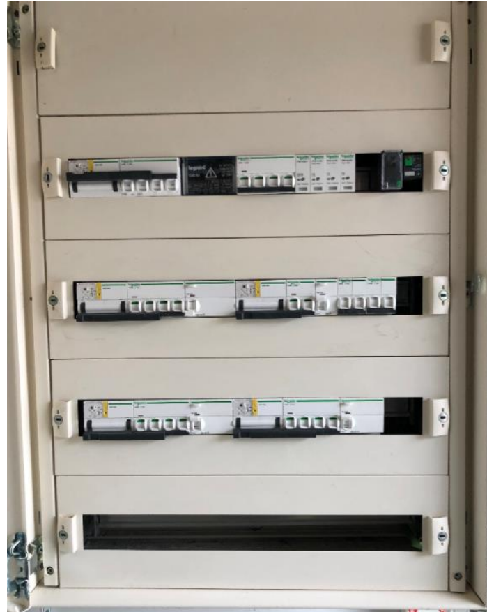
Cuadro eléctrico de baja tensión tipo
